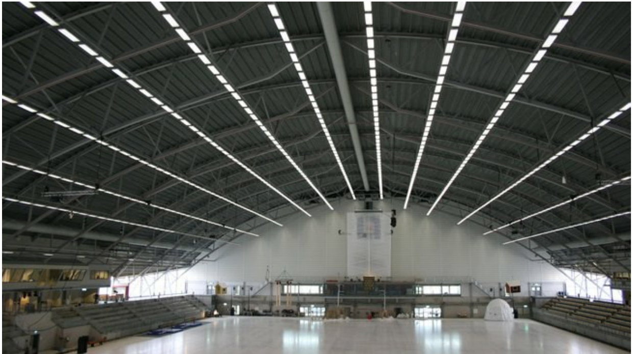
3 st Ø1.000 mm 106 meter långa don förser hela arenan med värme genom tilluften
