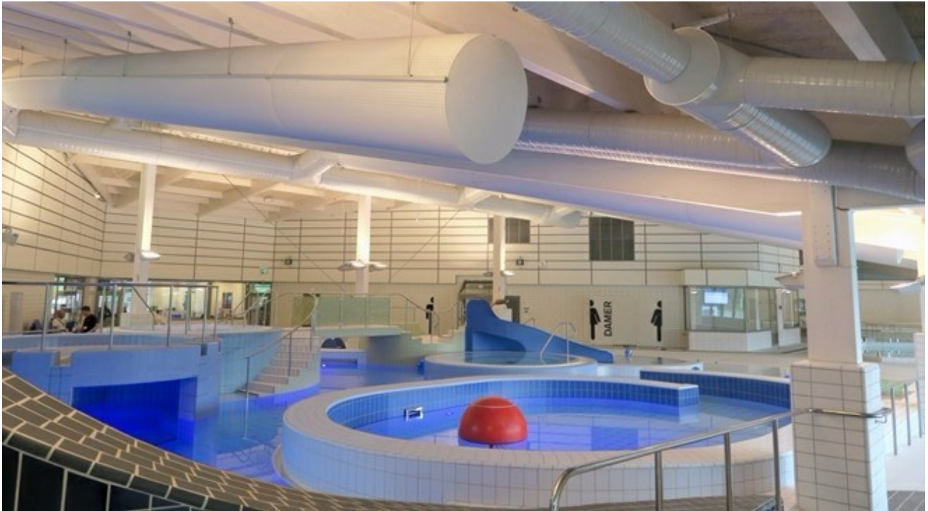
Injektdon på Hjortenbergsbadet
